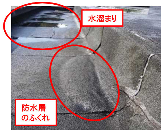
写真5 露出防水層のふくれなど
