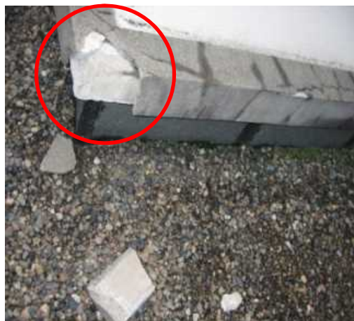
写真6 モルタル塗りの剥落
