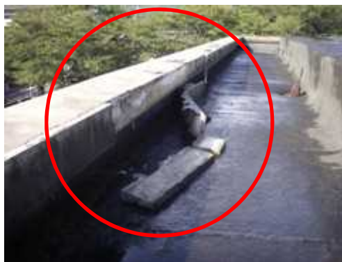
写真7 モルタル塗りの剥離
